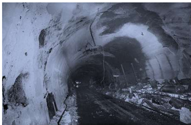
Slika 1. Posljedice požara u tunelu Mont Blanc 1999. 1
