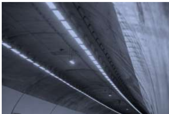
Slika 4. Prikaz linijskog javljača požara u tunelu
